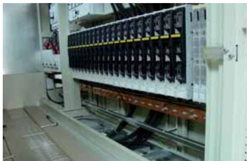
Beispiel Ausführung Niederspannungsverteiler
