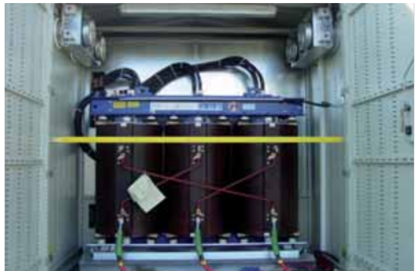
Beispiel Ausführung Transformatorraum
